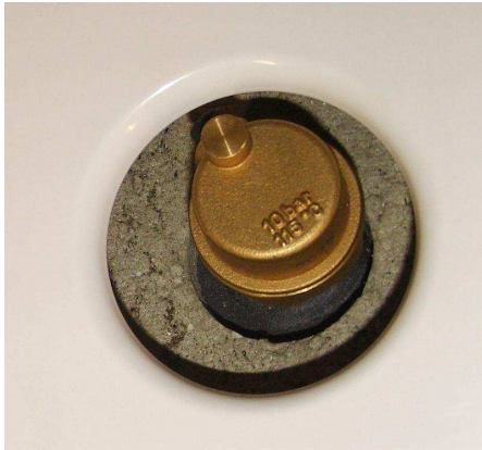
Obr. 14 Odvzdušňovací ventil kotlového tělesa
